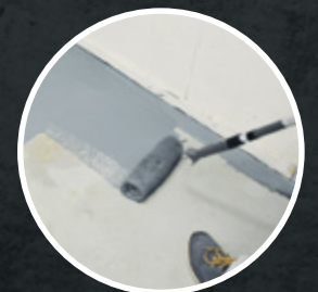
BETONNEN VLOEREN (POREUS)
